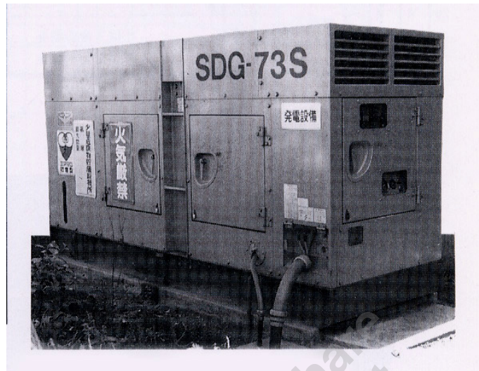
図 10 自家発電装置
